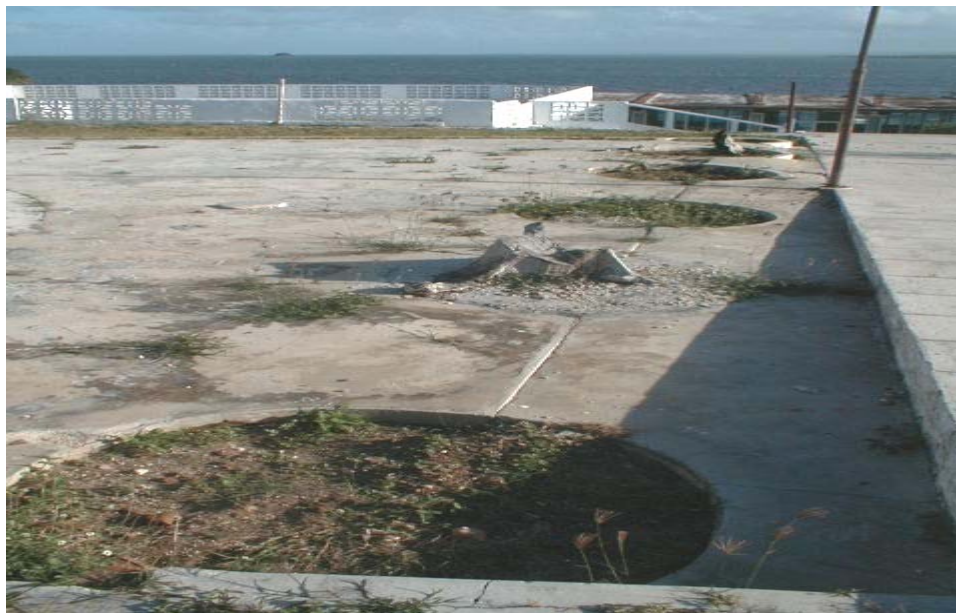
Figura 1: Estado actual de deterioro de las áreas recreativas de la Playa Mar Azul; Caibarién
