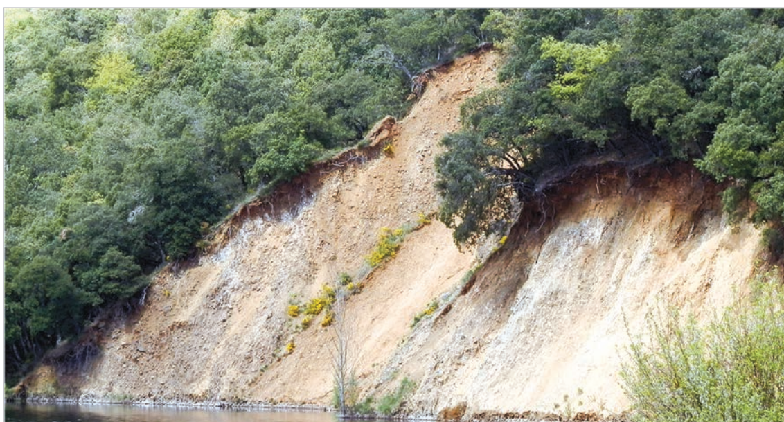
Figura 5. Detalle de los sucesivos deslizamientos de ladera enmarcados por la vegetación en el extremo occidental del frente de inestabilidad en el talud norte del lago. Se observa la litología ófítica subaflorante en la mayoría de la superficie expuesta sin vegetación. Fuente: Basoinsa, 2014.
