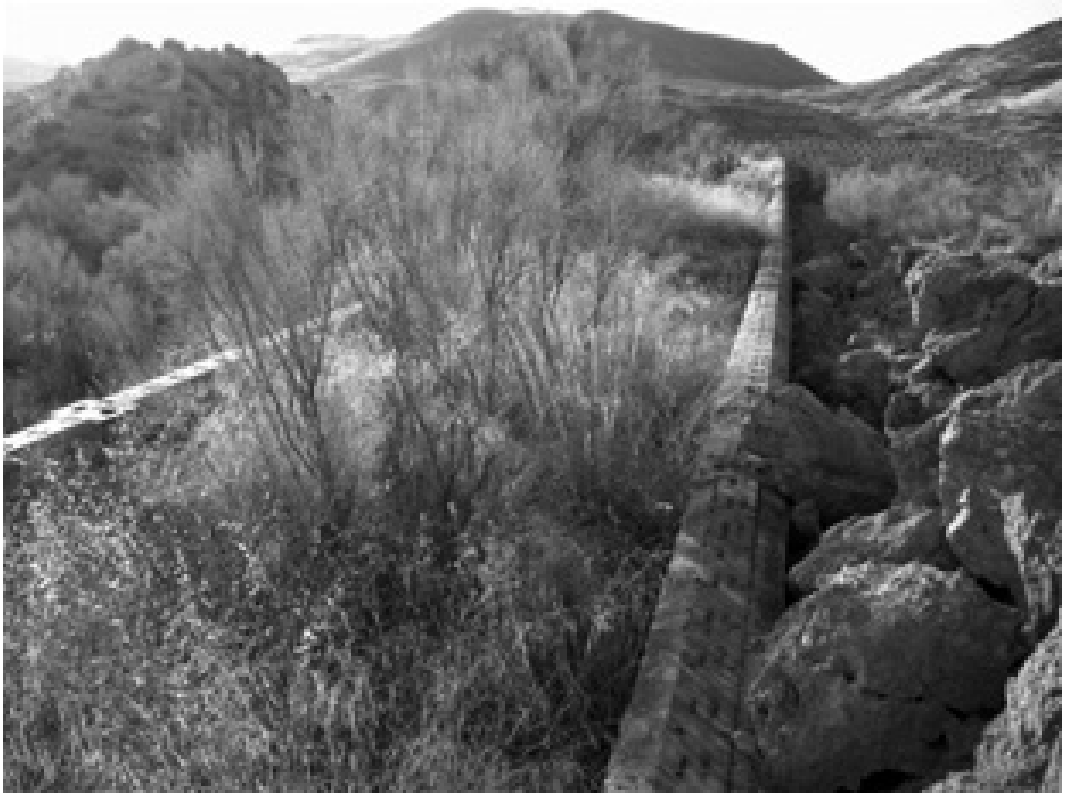
Estado actual de la trinchera abierta para el corrimiento de los tramos del tablero del viaducto del salado (lado de linares). Fuente: Casimiro Molina Cobos.
