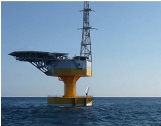
Subestación SPAR 66kV (Japan Marine United) Instalada Junio 2013
