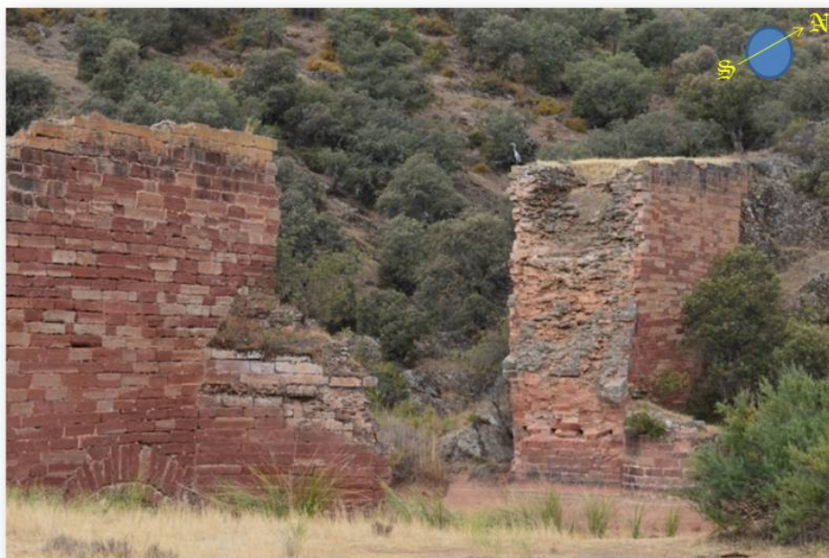
Restos de los estribos
