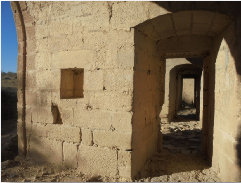
F13) Detalle del pasadizo que recorre el interior de los arcos de medio punto
