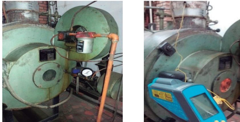
Figura 4. Toma de datos experimentales, caldera Continental F10C Fuente: Los autores
