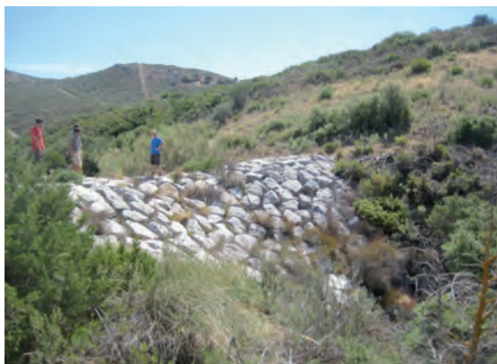
Figura 9. Presa para evitar la entrada de escorrentía en un sumidero kárstico.
