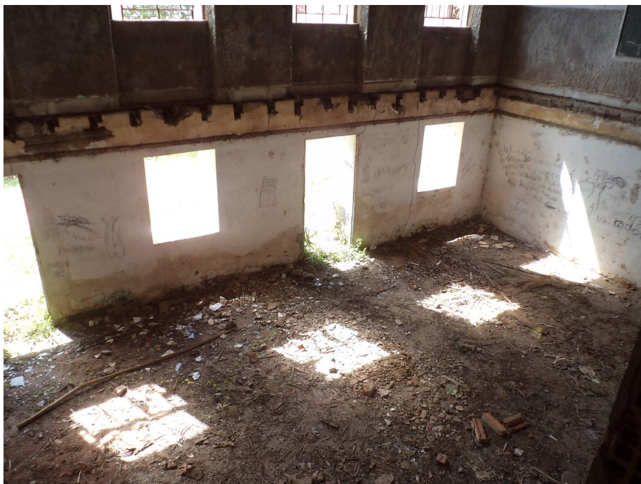
Figura 2: Vista interna do Pavilhão D e seu estado de arruinamento, Vila Santo Antônio do Prata, Igarapé-Açu (PA).
