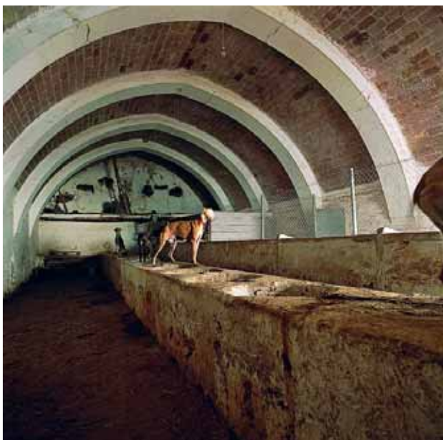
10. CUBIERTA DE NAVE A DOS AGUAS CONSTRUIDA MEDIANTE BÓVEDA DE LADRILLO APOYADA SOBRE ARCOS DIAFRAGMA.
