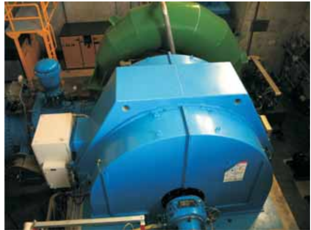
Foto 4. Turbina Francis, PCH Santa Ana.
