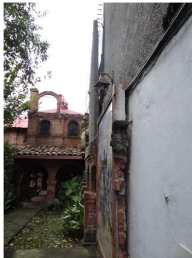
Figura 7. Desplome de la estructura. Fuente: propia, 2017.
