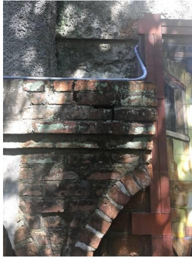
Figura 5. Desgaste y desprendimiento del material. Fuente: propia, 2017.
