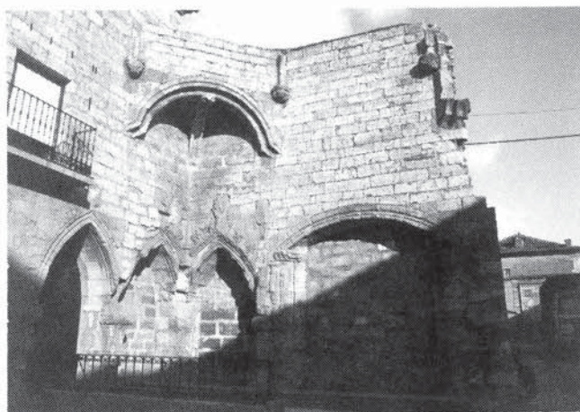
Foto n.º 2: Ruinas de la iglesia conventual de San Idefonso. Importante edificio religioso desde su fundación en el siglo XIII. En sus capillas se reunían el estado de pecheros para deliberar sobre asuntos de trascendencia económica y social.
