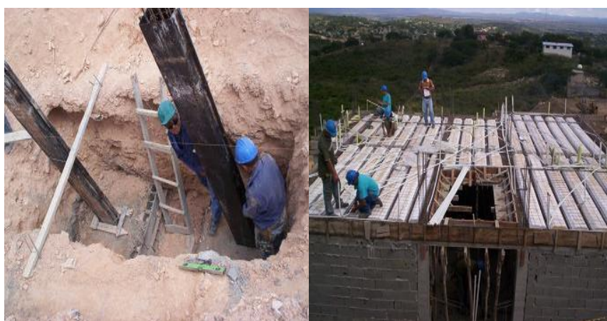
Figura 4. (a) Fundaciones (b) Entrepiso nervado. Fuente: M. Dikdan, J. Yepez, D. Avon, R. Rojas [8]
