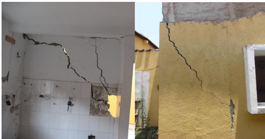
Figura 3. (a) Agrietamiento en paredes (b) Agrietamiento en fachada. Fuente: M. Dikdan, J. Yepez, D. Avon, R. Rojas [8]
