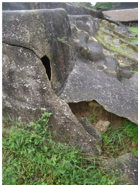
Figura 3: El uso de revoques de cemento ha propiciado la destrucción de los sustratos de ladrillo y adobe en la zona arqueológica de Comalcalco, Tabasco, México (2013).
