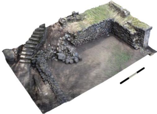
Figura 12: Vista en perspectiva del derrumbe en el muro de la Zona 1 (2015). Fuente: PAR.
