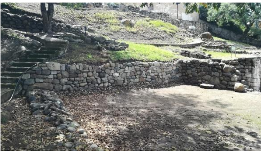
Figura 14: Muro intervenido por ERA Cultura en 2015 (2017). Fuente: Fotografía tomada por Freddy Espinoza F.
