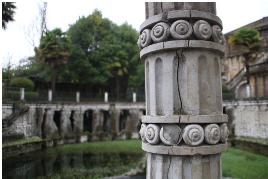
Fig. 13. Estado de deterioro dunha das columnas do templete do Pasatempo.
