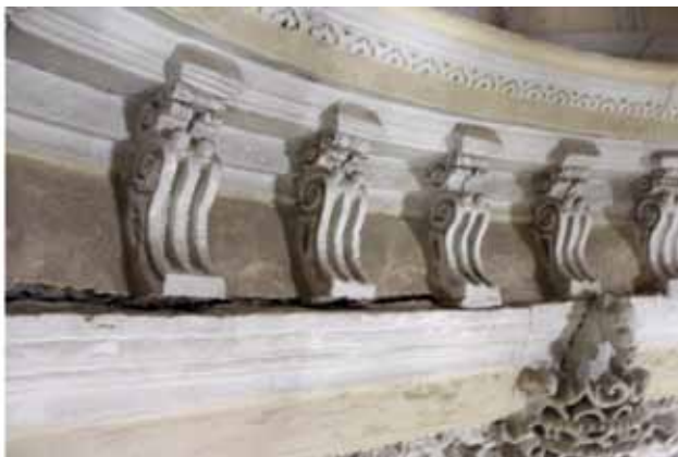
Fisura en el anillo de la cúpula. Foto P. Pastor.
