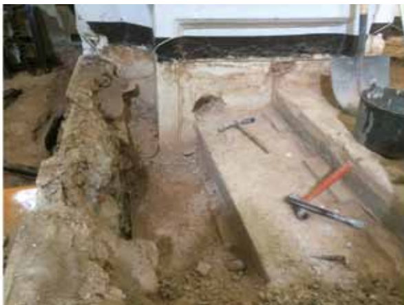
Peldañeado original del presbiterio. Patologías. Foto P. Pastor.
