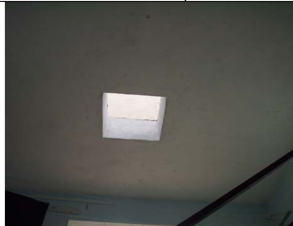
No existen tapas en salida a cubierta
