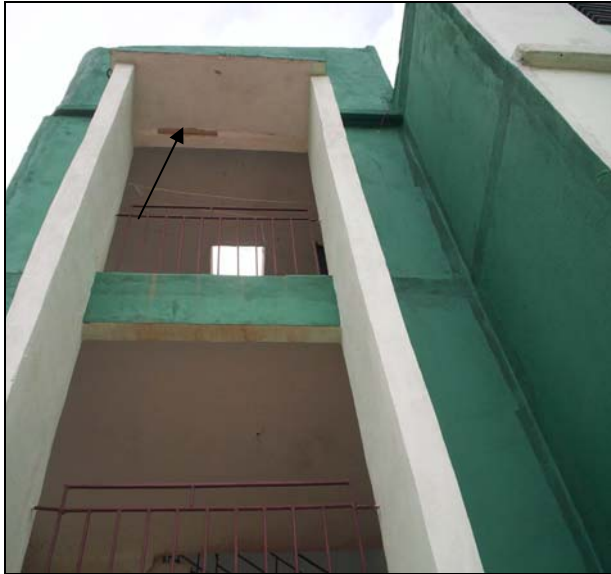
Remates entre elementos prefabricados con juntas fisuradas, desprendiéndose fácilmente.
