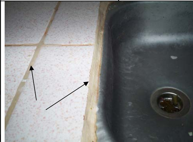
La colocación de los azulejos es deficiente, existen juntas sobre dimensionadas, saltillos
