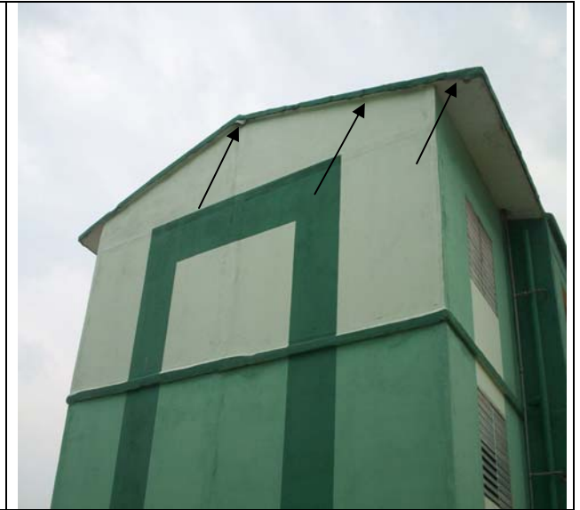
Mantas de impermeabilización despegadas
