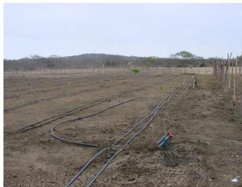
Imagen 12 Vista de un sector donde se colocaron tuberías de riego luego de un proceso adicional con digestores de lodos
