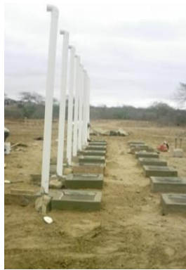
Imagen 10 vista superior del sistema sanitario, se aprecia las cajas de control y las tuberías de ventilación
