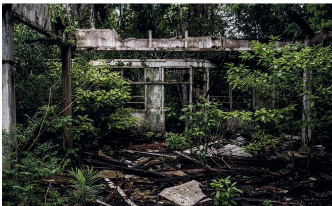
Imagen 2. La selva «invasora» traspasa los muros deteriorados del hospital de Fordlandia (2017, Denton) Fuente: New York Times.
