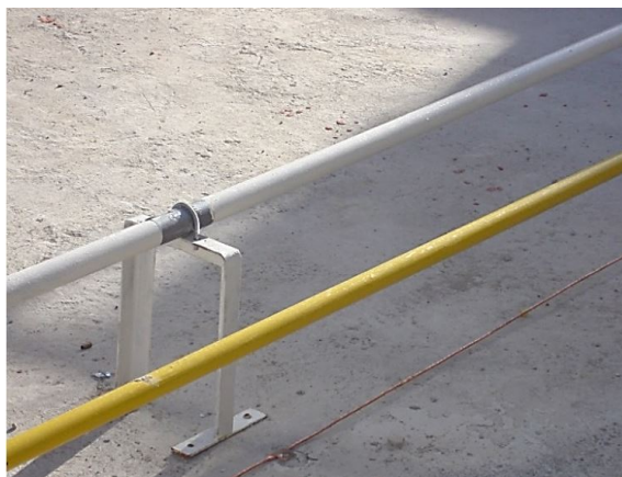
Figura 5. Señalización de tuberías de GLP (amarillo GLP vapor, blanco GLP líquido).
