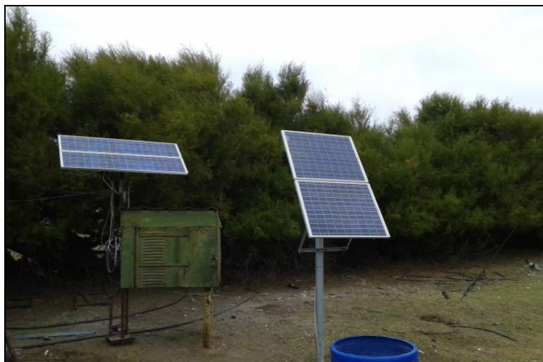
Ilustración 5: paneles solares del programa PERMER instalados en el predio
