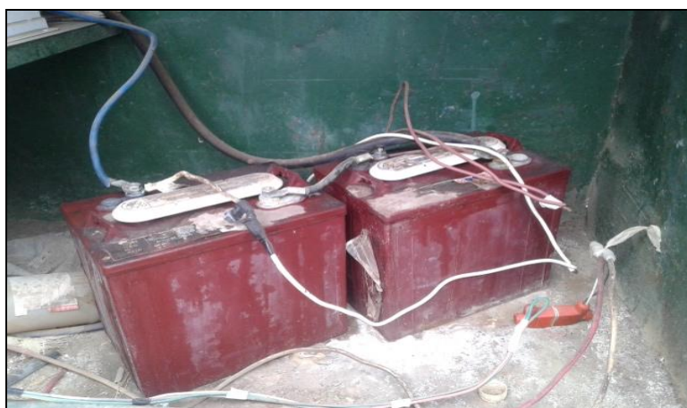
Ilustración 6: banco de baterías de plomo-ácido existente
