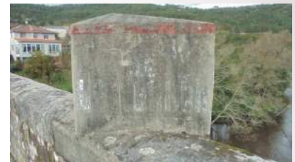
Hito kilométrico colocado en le pretil del Puente, señala el límite de las provincias de A Coruña y Pontevedra.
