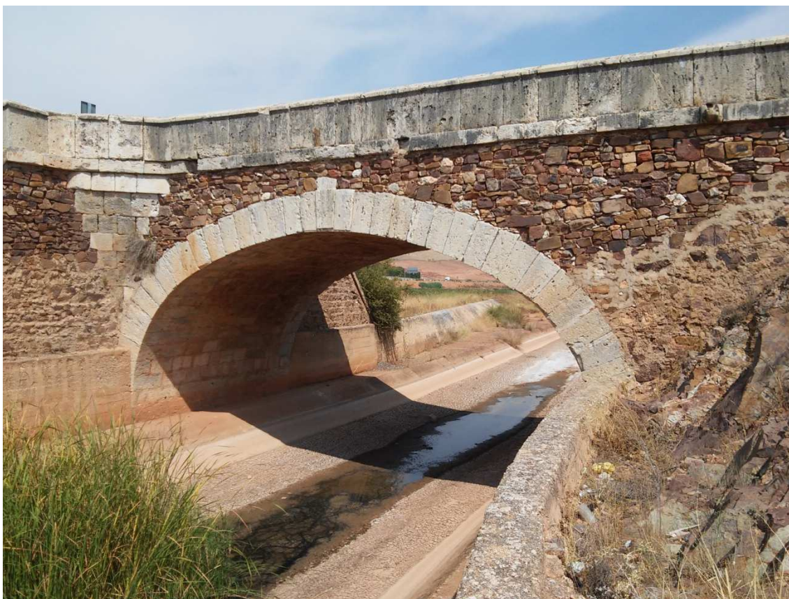
Puente de San Miguel sobre el río Jabalón encauzado. Foto M. Roll
