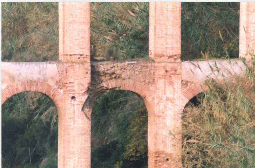
Deterioros en la fachada sur del acueducto.
