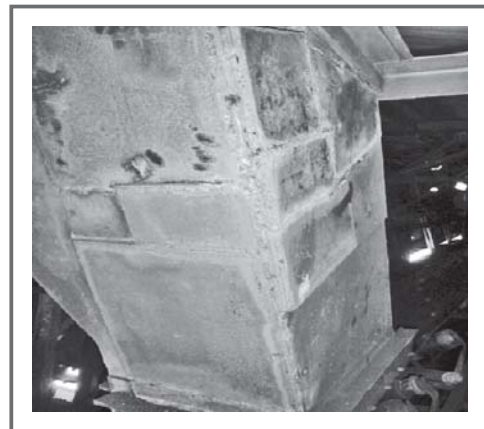
Figura 6. Estado Atípico de la estructura metálica de la Tolva de Traspaso BTT24 - BTT25.
