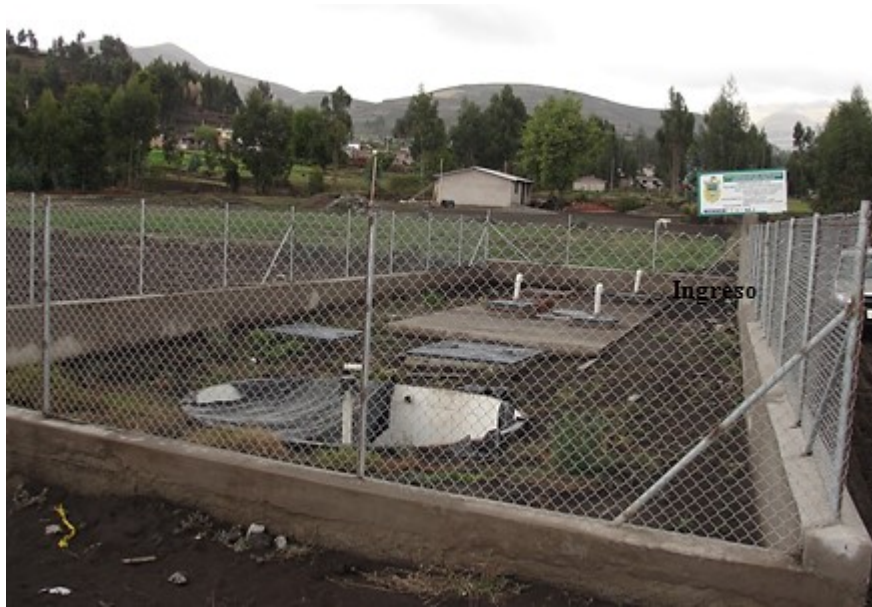
Figura 1. Planta de tratamiento de aguas residuales de Pulinguí, cantón Guano, Chimborazo
