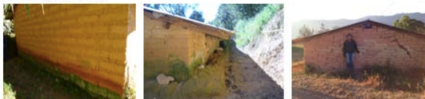
3. Agrietamiento en dinteles
