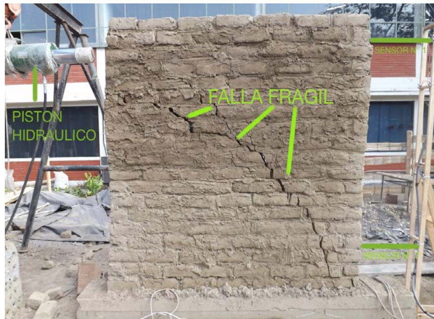
Figura 4. Falla del muro de adobe en aparejo convencional (Crédito: CECOS-BRIGURP, 2015)
