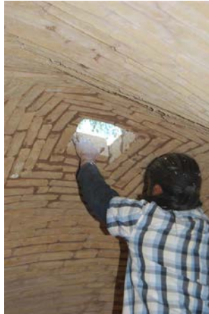
Figura 2. Cierre de una bóveda de adobe y mortero de barro con cal (Foto: L. Guerrero, 2015).
