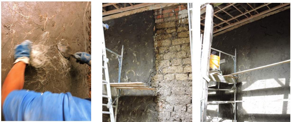
Figura 2. Aplicación de la primera capa de "cabuya enredada" en un muro de adobe
