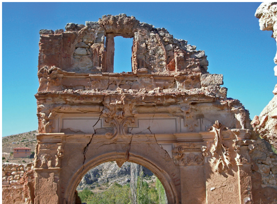
Fig. 5.- Estado actual de los lienzos interiores de fachada oeste. Arranques de los arcos y decoración interior.
