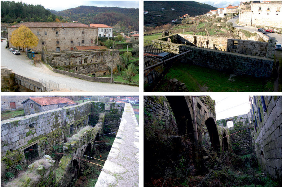
Figura 3: O aljube após as obras de emergência a esquerda superior o alçado Norte, a direita superior o alçado Sul, a esquerda e direita inferior o interior do aljube.
