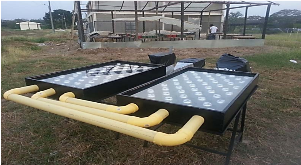
Fig. 6. Fotografía de los colectores solares. Fuente: Autores
