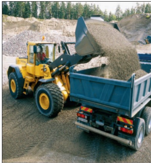
Figura 12. Etapa de carga y descarga del material retirado en el camión de transporte. (Volvo Construction Equipment)
