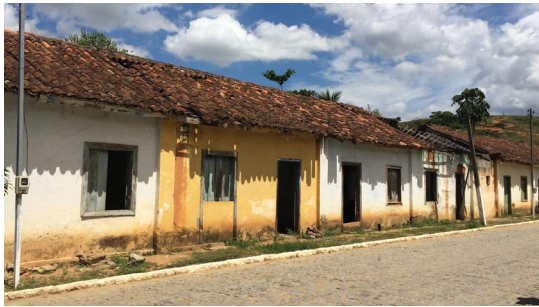
Fot. 3 - Vila abandonada por conta dos efeitos da inundação de janeiro/2012 na localidade de São Pedro do Paraíso (Fotografia de Cármen Ferreira, abril de 2015).
