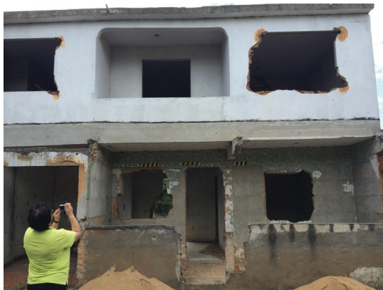
Fot. 4 - Residência interdita pela Defesa Civil por conta dos efeitos da inundação de janeiro/2012 na área urbana de Cardoso Moreira (Fotografia de Raul Reis Amorim, abril de 2015).
