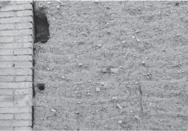
Figura 4. Esquerdes per discontinuïtat de material
