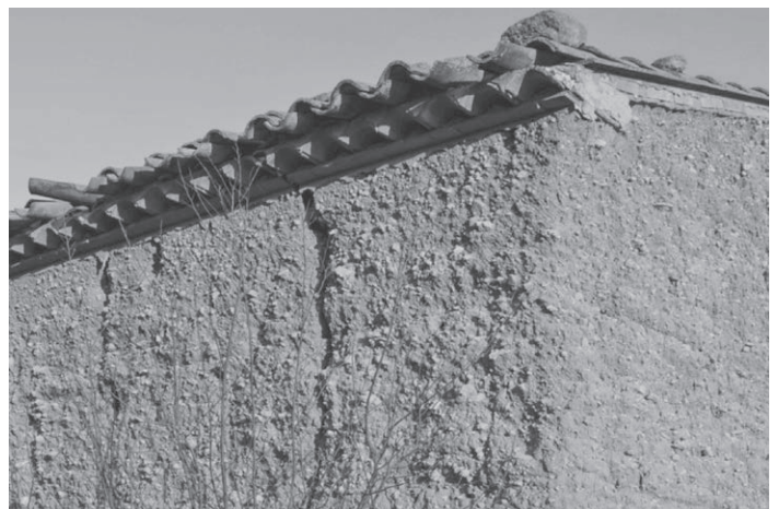
Figura 5. Esquerdes per assentament de la fonamentació
