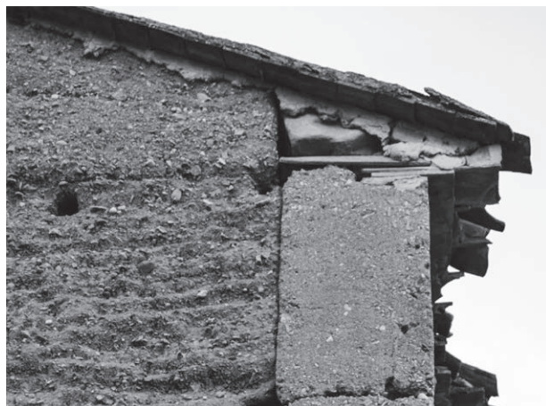
Figura 3. Esquerdes per l'empenta de la coberta
