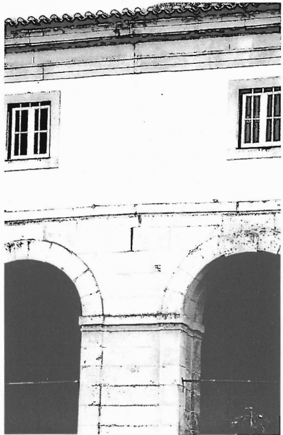
Foto 41 - Exemplo de Quebra Claustral, neste caso no Alçado Norte da Ala Sul do Claustro do Cardeal. No outro lado foi edificado grosso botaréu de contenção entre esta zona e a Sacristia Manuelina (P.TAVARES, 1999).
