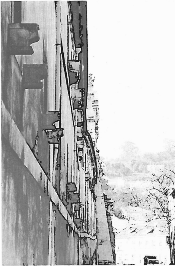
Foto 39 - Deslocamentos tridimensionais no Alçado Norte dos Claustros do Cardeal e do Rachadouro (Rua D. Pedro V), ocasionados por assentamentos no edificado em virtude de empapamento dos solos ocasionado pelas cheias (P.TAVARES, 1999).
