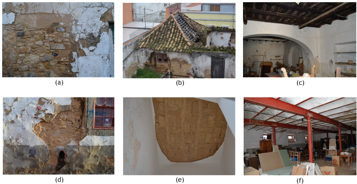
Fig. 2 - Exemplo de alvenaria de pedra muito pobre e irregular (a) e paredes em taipa com pequenos fragmentos de pedra (d), “telhados em tesouro” (b) e terraços em “Santa Catarina” (e), e ainda, estrutura de pavimento com barrotes de madeira (c) e com vigamento metálico (f).
