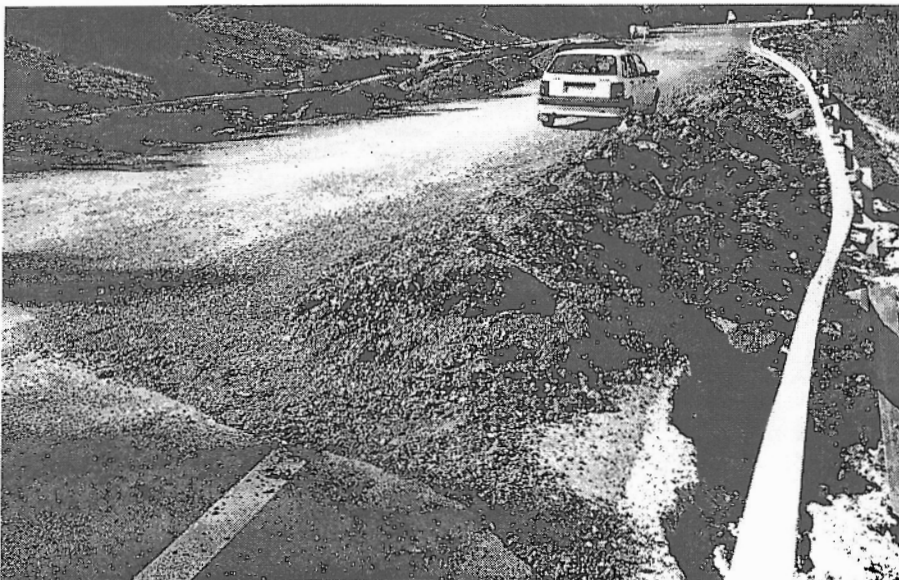
Fot. 3 - Deslizamento de terrenos que em Janeiro de 1996 destruiu a E.N. 342 a toda a sua largura.
