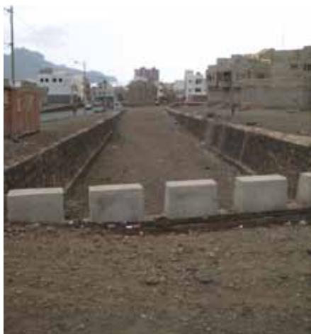
Fot. 3 - Canal e novas habitações no sentido do escoamento, em Chã de Alecrim.
