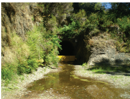
Fot. 8 - Açude do Ceiroco: Pormenor da saída do túnel do Alto Ceira, com a passagem barrada devido às obras de conservação (fotografia de Carlos Cruz).
