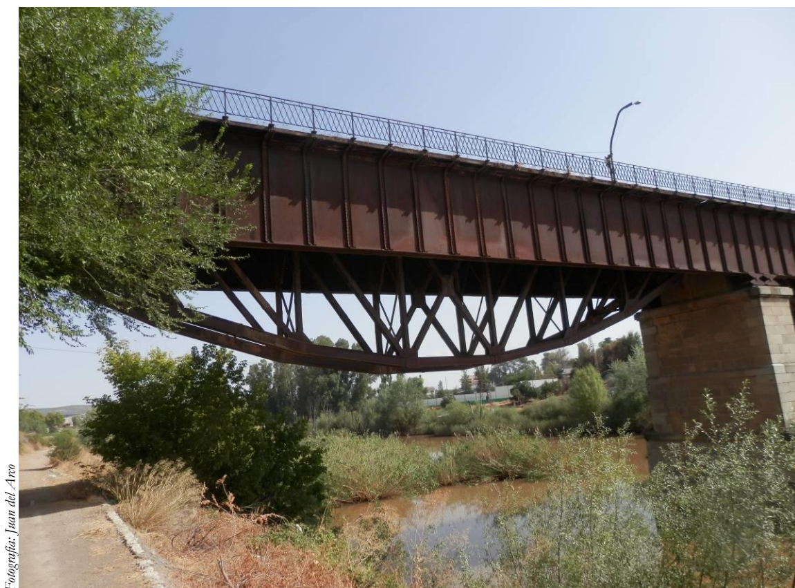
Viga vientre de pez
