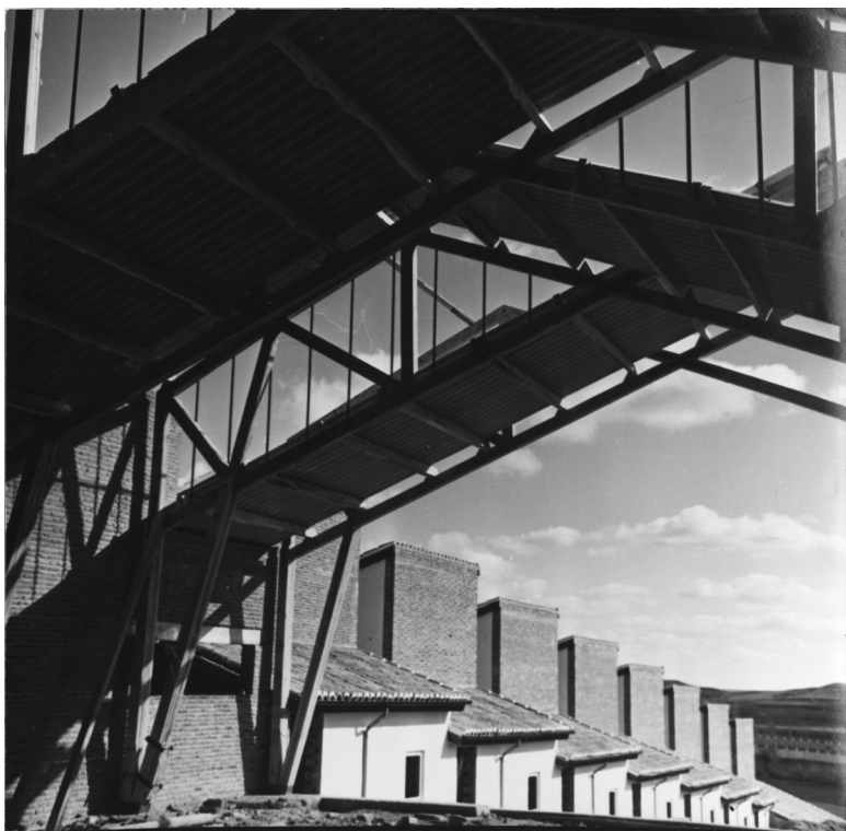
(Fig. 9) Ejecución de obra. Centro de segunda enseñanza y enseñanza profesional en Herrera de Pisuerga (1954-56). Jose Antonio Corrales y Ramón Vázquez Molezún. Conversación estudio Jose Antonio Corrales. Madrid. 6-02-2004.
