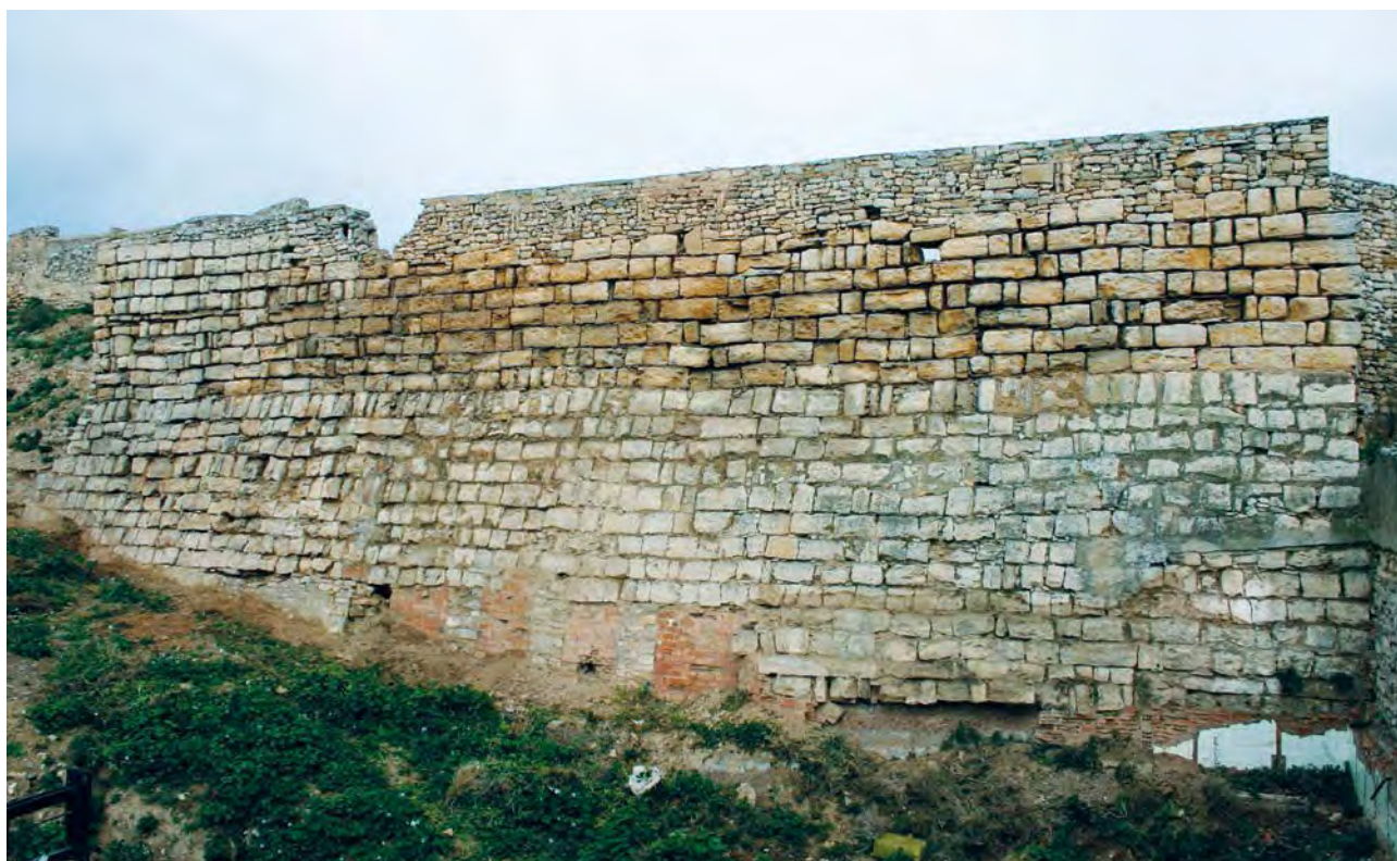
Figura 17. Mur sud del segle xv, amb l'afegit superior del segle xix i apuntalaments moderns a la zona inferior. Imatge anterior a la restauració.
