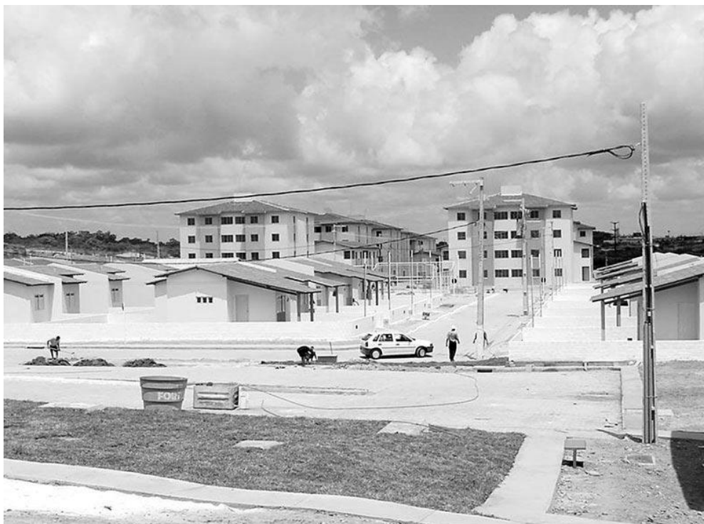
Figura 03: Residencial Vila Vitória, na época da sua construção em 2004. Foto: Prefeitura Municipal de Aracaju, 2004.
