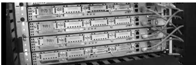
Fotografía 2. Vista del laboratorio - Enrutadores de acceso (clientes).
