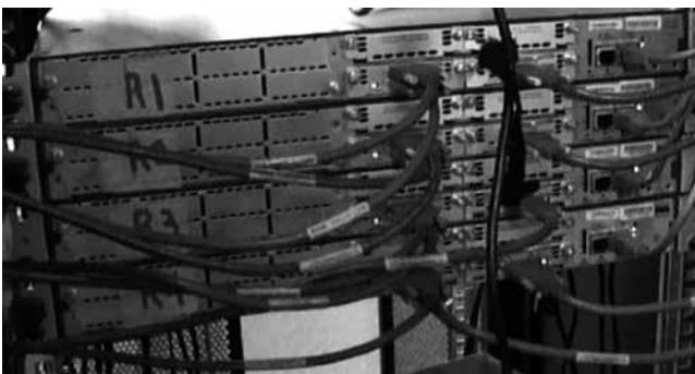
Fotografía 3. Vista del laboratorio - Enrutadores del núcleo.
