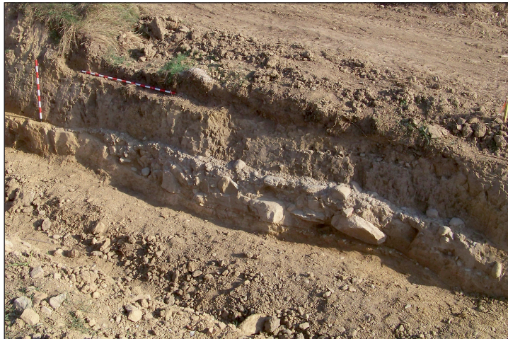
Figura 2. Sección transversal sur de la calzada en la zona denominada como área 1.
