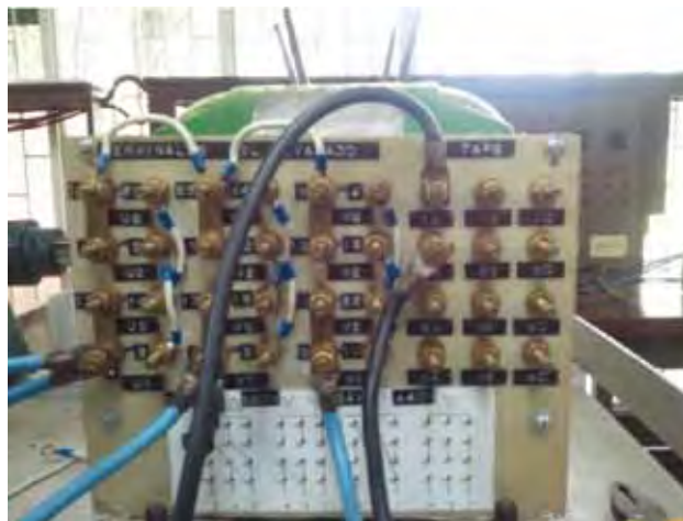
Figura 4. Tablero de conexiones del motor modificado para introducir las diferentes condiciones de falla
