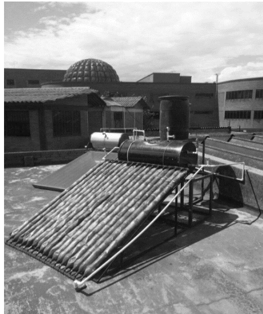
Figura 10. Ensamble, tanque, captador solar, instrumentos y accesorios para su correcto funcionamiento.
